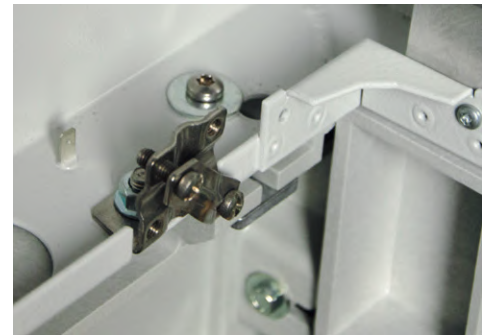
7C Befestigte Erdungsklemme im Zwischensockel.
