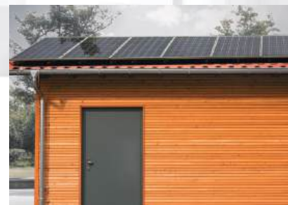
Mit integrierter Photovoltaik
